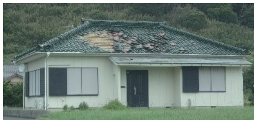
強風により屋根の被害を受けた南房総市の住宅 (出典：国土交通省)
